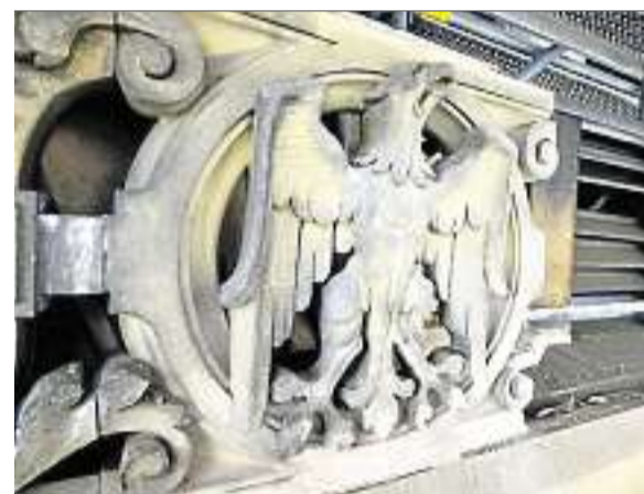
Auch der durch Wind und Wetter schmutzig gewordene Adler gehört ins Sanierungspaket.
